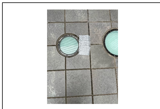
写真 1 ガムテープで応急補修されたタイル
