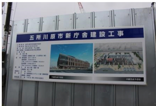
↑市立西北中央病院の跡地に建設中の 五所川原市新庁舎
