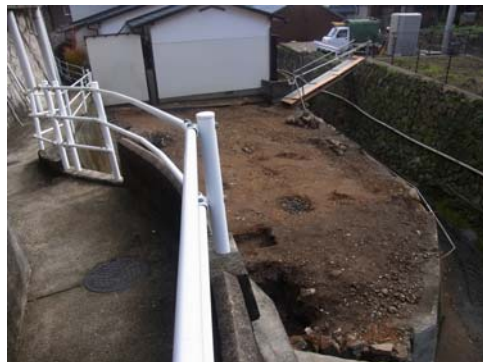
図14 車両の横付けができず 川に橋を架けて解体を行う事例
